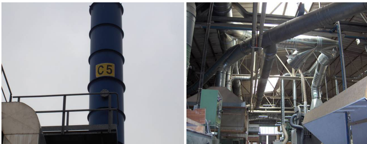
A sinistra un camino univocamente identificato (in riferimento al decreto di autorizzazione) e, a destra, un esempio di difficile identificazione di emissioni convogliate
