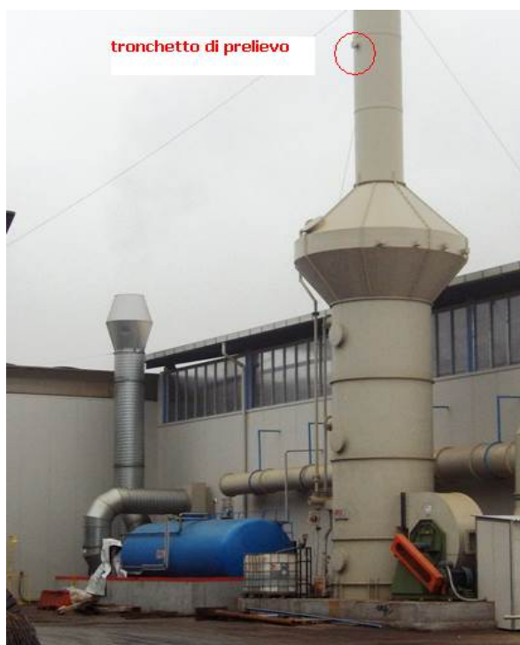
Nuovo impianto con accessibilità mancante e non prevista
