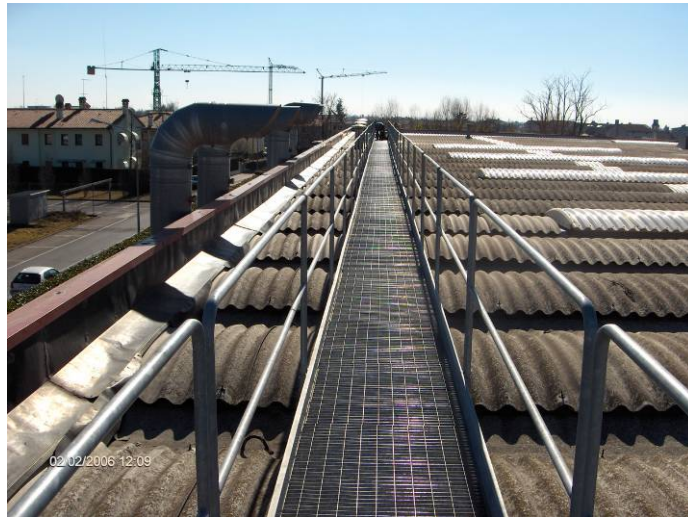
Passerella con regolare parapetto su tetto in “eternit”
