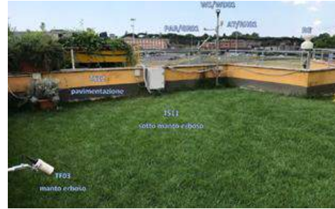
Sensori disposti a livello di tetto verde
